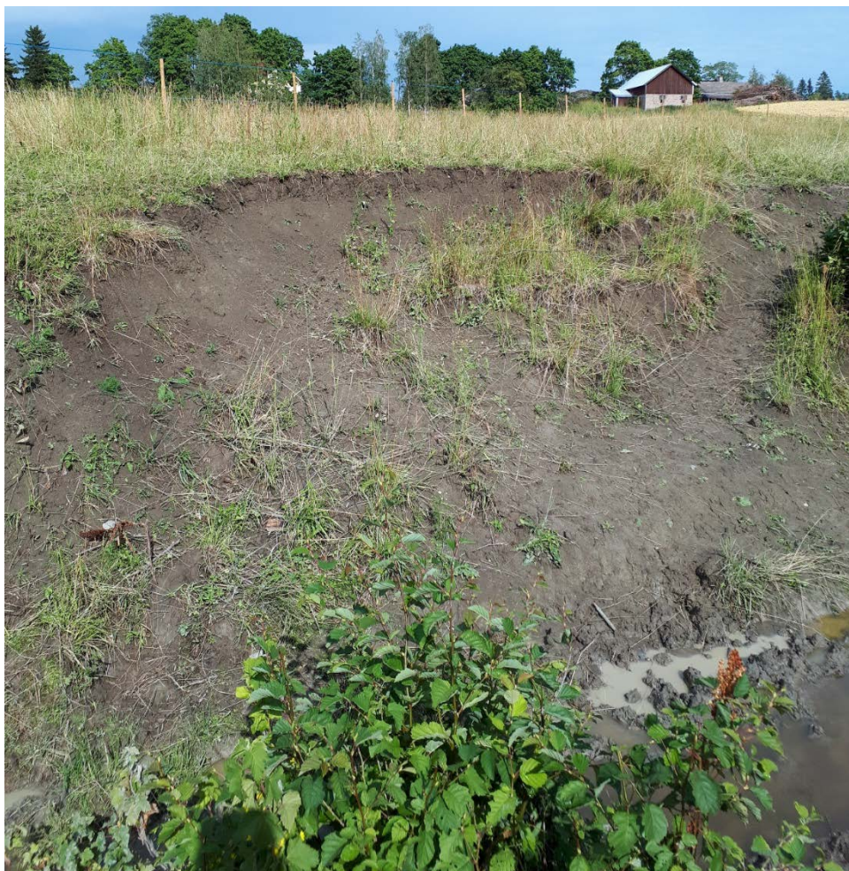
Bild 4. Ett färskt släntskred. Slänterna borde täckas med t.ex. sprängsten för att bli stabilare.
