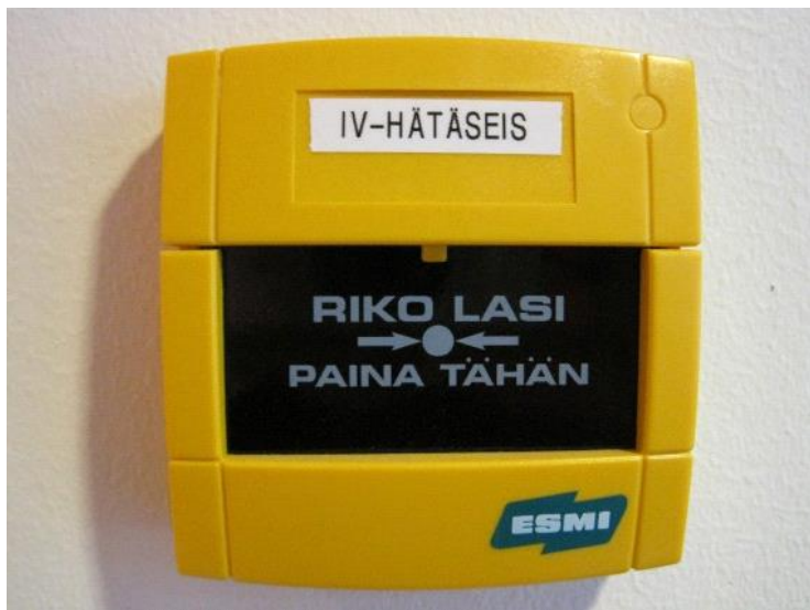
Bild 2 Nödavbrytare för luftväxlingen
