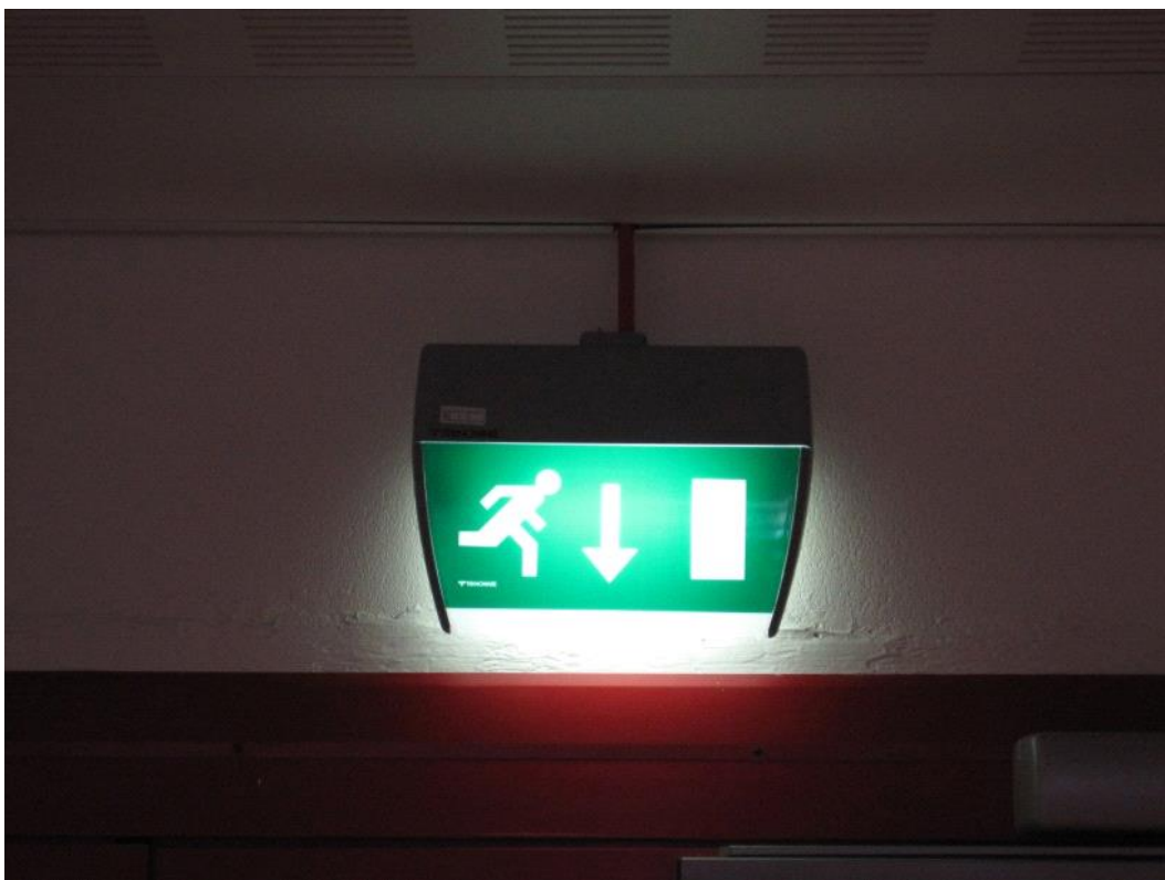
Bild 3 (Vägledningsbelysning som visar utrymningsriktningen)
