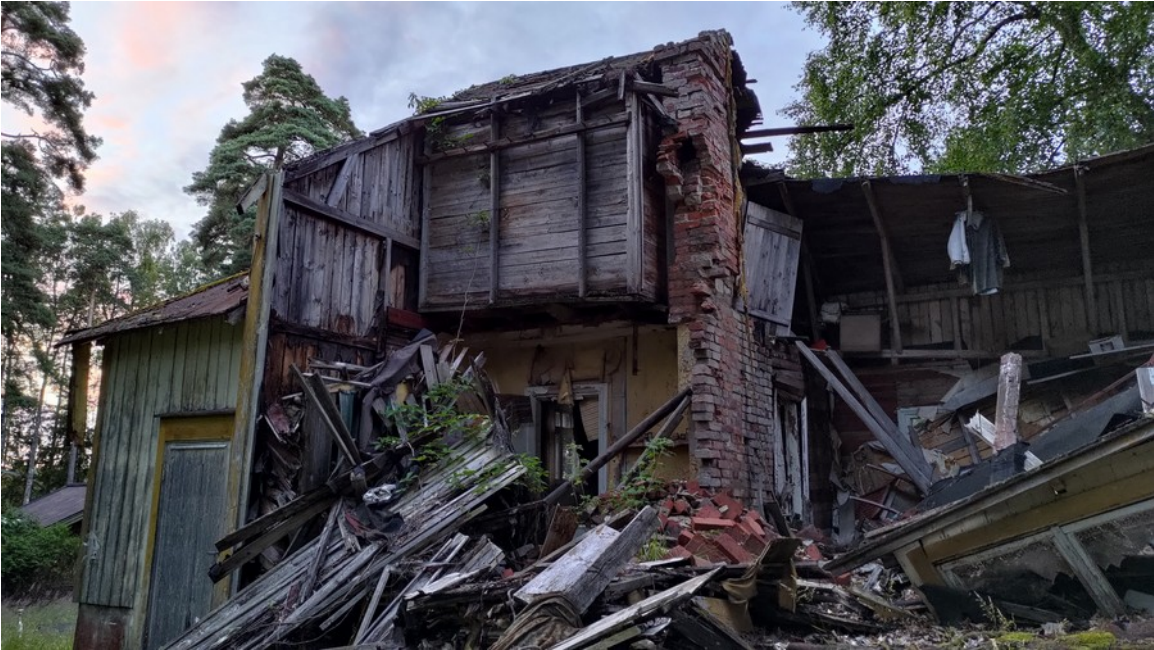
Kuva 4.6. Pihapiirin vanha päärakennus on puoliksi romahtanut.
