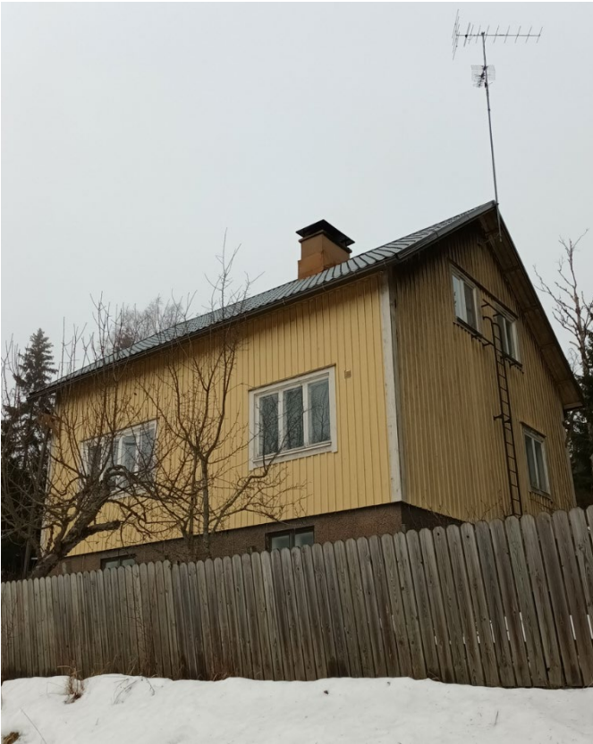
Kuva 12. Vanha Turuntie 107, talo on rakennettu 1940–1950-luvulla. Osa ikkunoista on uusittu, katto on uusittu ja kattoerkkeri talon pohjoispuolella on rakennettu vuoden 1995 jälkeen. Laudoitus todennäköisesti alkuperäisessä muodossaan.
