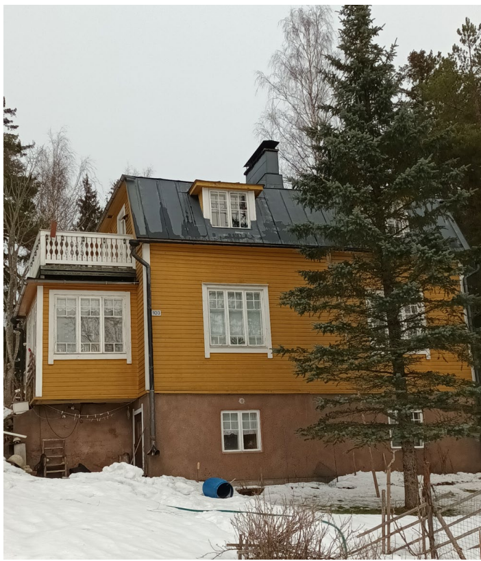
Bild 10. Gamla Åbovägen 103, huset byggt på 1920–1930-talet. Huset har gamla fönster, i en del har fönsterglasat förnyats.
