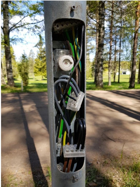
Kuva 8. Pylvään kytkentätila ja pylväskalustesarja
