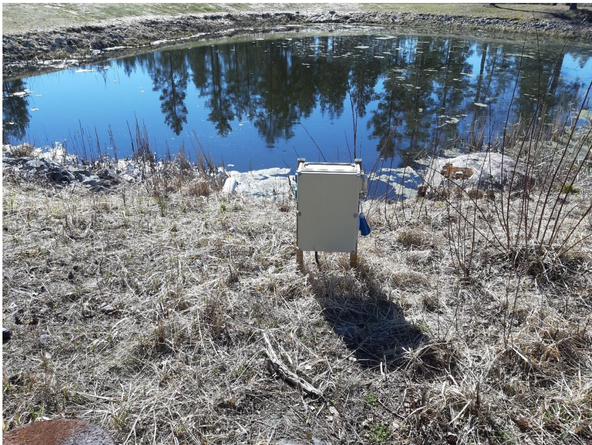
Kuva 24. Jätevesipumppaamon JVP1 ylivuoto läheiseen lammikkoon.
